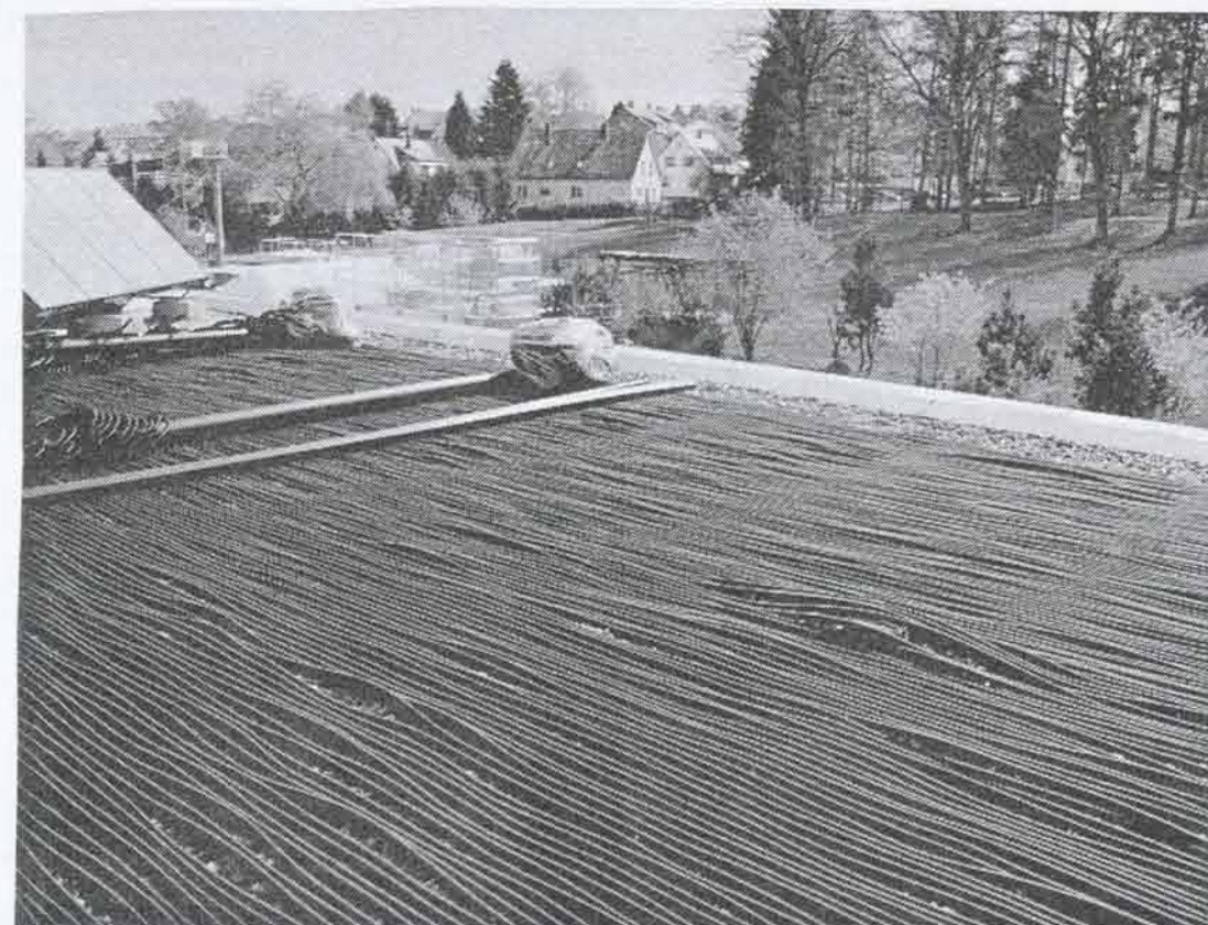
EINEN KLEINEN BEITRAG zur Reduzierung des Treibhausgasess will Karlsbad mit der neuen Solarabsorberanlage auf dem Flachdach des Schwimmbeckens leisten. Foto: v. Bischoffsheim
