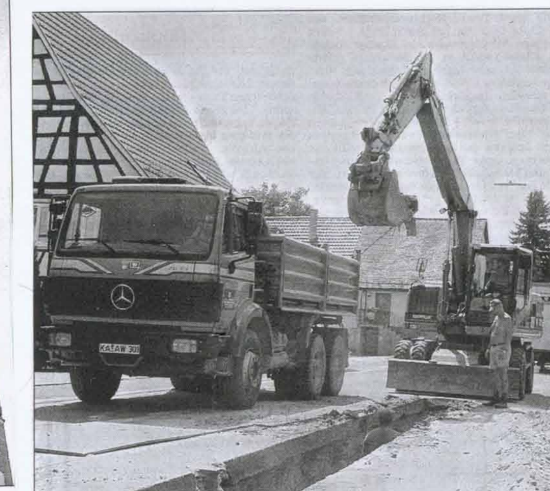
TIEFBAUARBEITEN sind in der Lange Straße im Karlsbader Ortsteil Ittersbach in Gang. Ersetzt wird dort die 70 Jahre alte Wasserleitung. Foto: Weber
