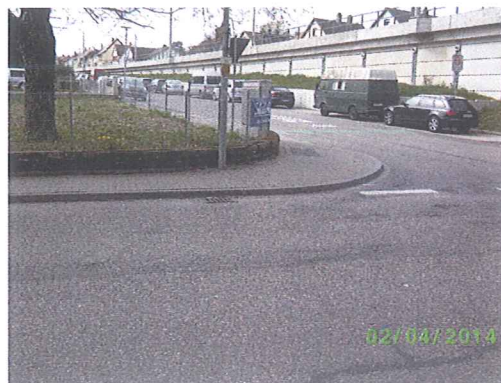
Bild 10: Absenkung Ettlinger Straße / Ecke Eisenbahnstraße
