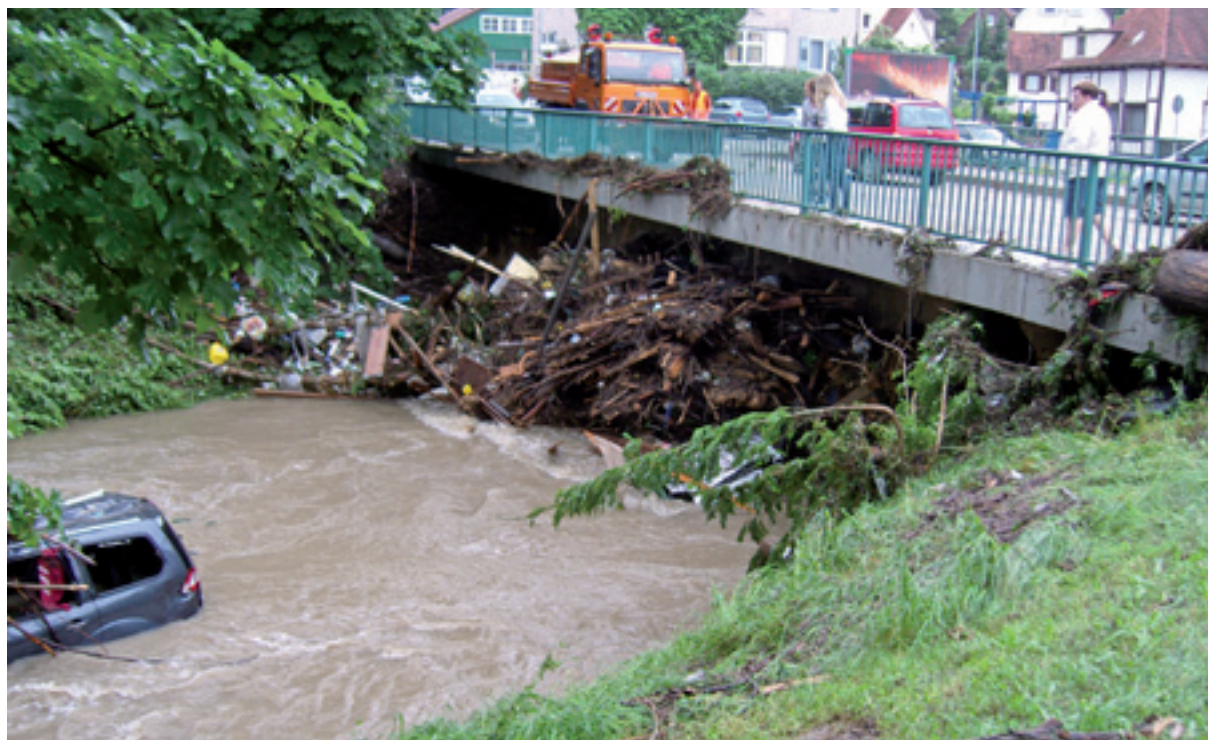
Abb. 16: Verklausung einer Brücke an der Starzel bei einem Hochwasserereignis im Jahr 2008
